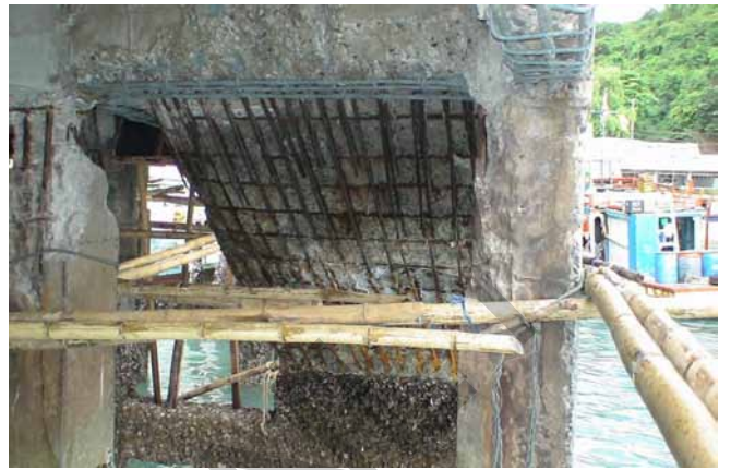
สภาพใต้ท้องพื้นบันได เหล็กเสริมเป็นสนิมก่อนทำการซ่อมแซม
