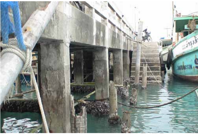
สภาพเสาและคานใต้ท่าเทียบเรือ พื้นผิวคอนกรีตมีความเสียหาย
