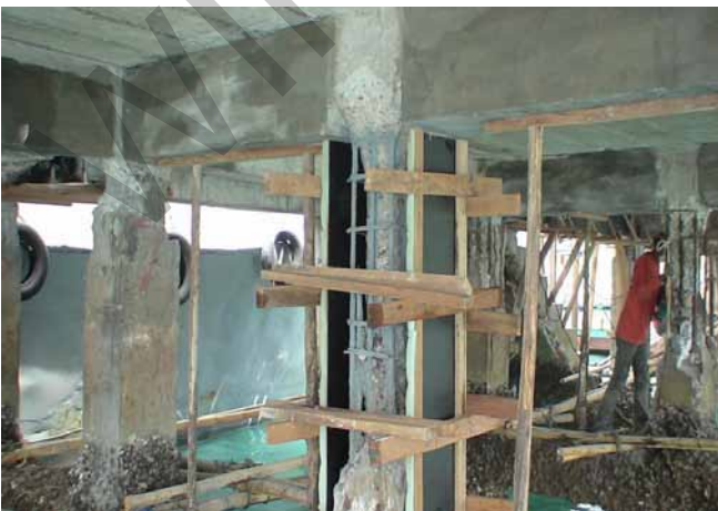
เข้าแบบเสาที่ซ่อมแซมเพื่อเตรียมเทซ่อมโครงสร้างด้วย Nonshrink Grout
