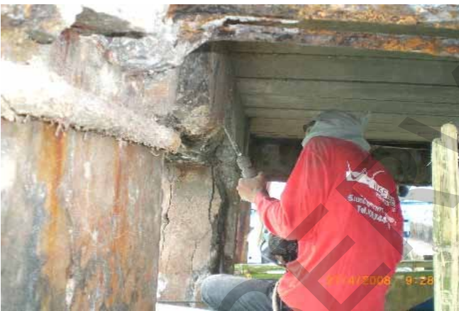
สกัดคอนกรีตส่วนที่เสียหายจนถึงคอนกรีตที่ดี
